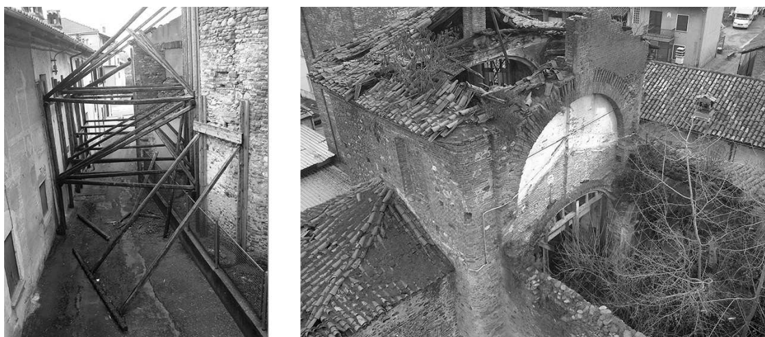
Puntellazione provvisoria 1998 e stato di degrado nel 2014
