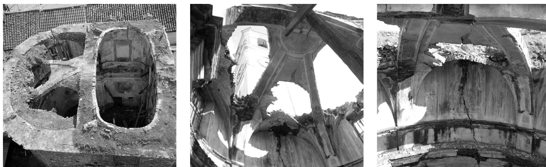
La situazione gravemente compromessa dell'abside dopo lo smontaggio del tetto (2015)
